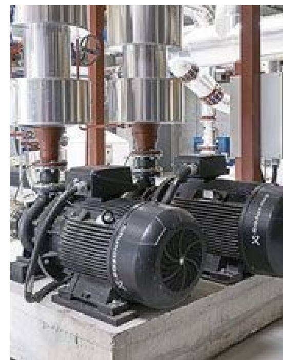
Sollicitation forte pompage
