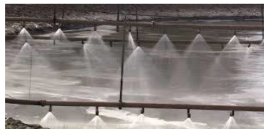
Figure 2 : Batterie à sprays d'eau
